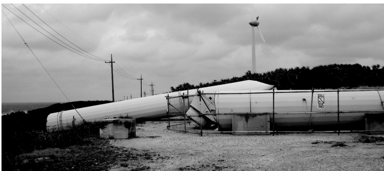
写真4 台風で倒壊した風力発電施設(2004年、筆者撮影): 折れたタワー(手前)と羽根が折れたブレード部(遠方)。
